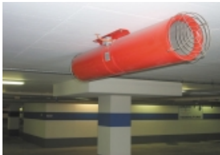
Bild 1: Impulsventilator in der Tiefgarage
